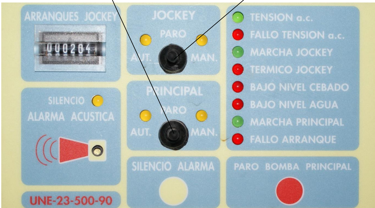
Panell de control de comandament
